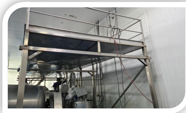
PLATAFORMA ELEVADA PARA TANQUE DE MEZCLADO INDUSTRIA CARNICA
